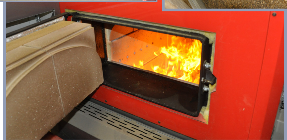
Chaudière, silo et dessileur.
